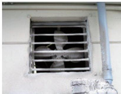
②製造場の換気扇
