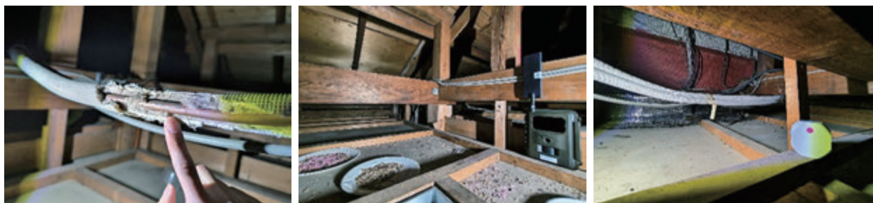
写真1 ネズミの齧り被害
